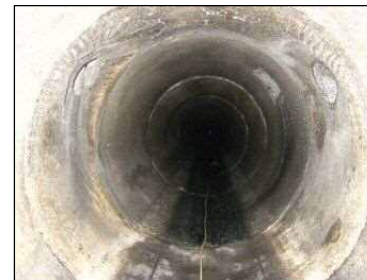
古く老朽化した下水道管
